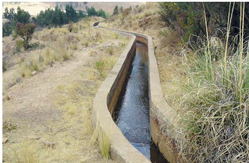
Canal principal en funcionamiento, 2011.
